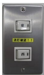
照明スイッチの消灯掲示
